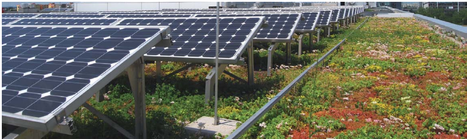
Eine Photovoltaik-Anlage auf einem Dach mit extensiver Dachbegrünung: Durch Verdunstungskühlung können Pflanzen den Ertrag von Solaranlagen verbessern.
