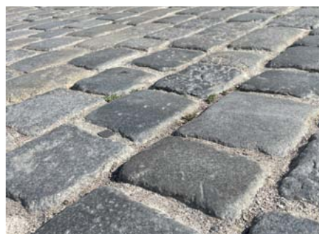
Vorher: Schlecht befahr- und begehbare Natursteinpflaster in ungebundener Bauweise.
