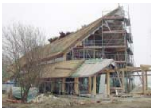
Gut Ding will Weile haben: das Mecklenburger Hallenhaus in der Bauphase. Während der IGA wird es Zentrum der berufsständischen Informationen durch den Landesverband Mecklenburg-Vorpommern sein.
